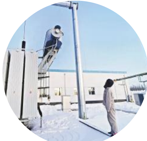
赤峰电站运维人员巡检设备
