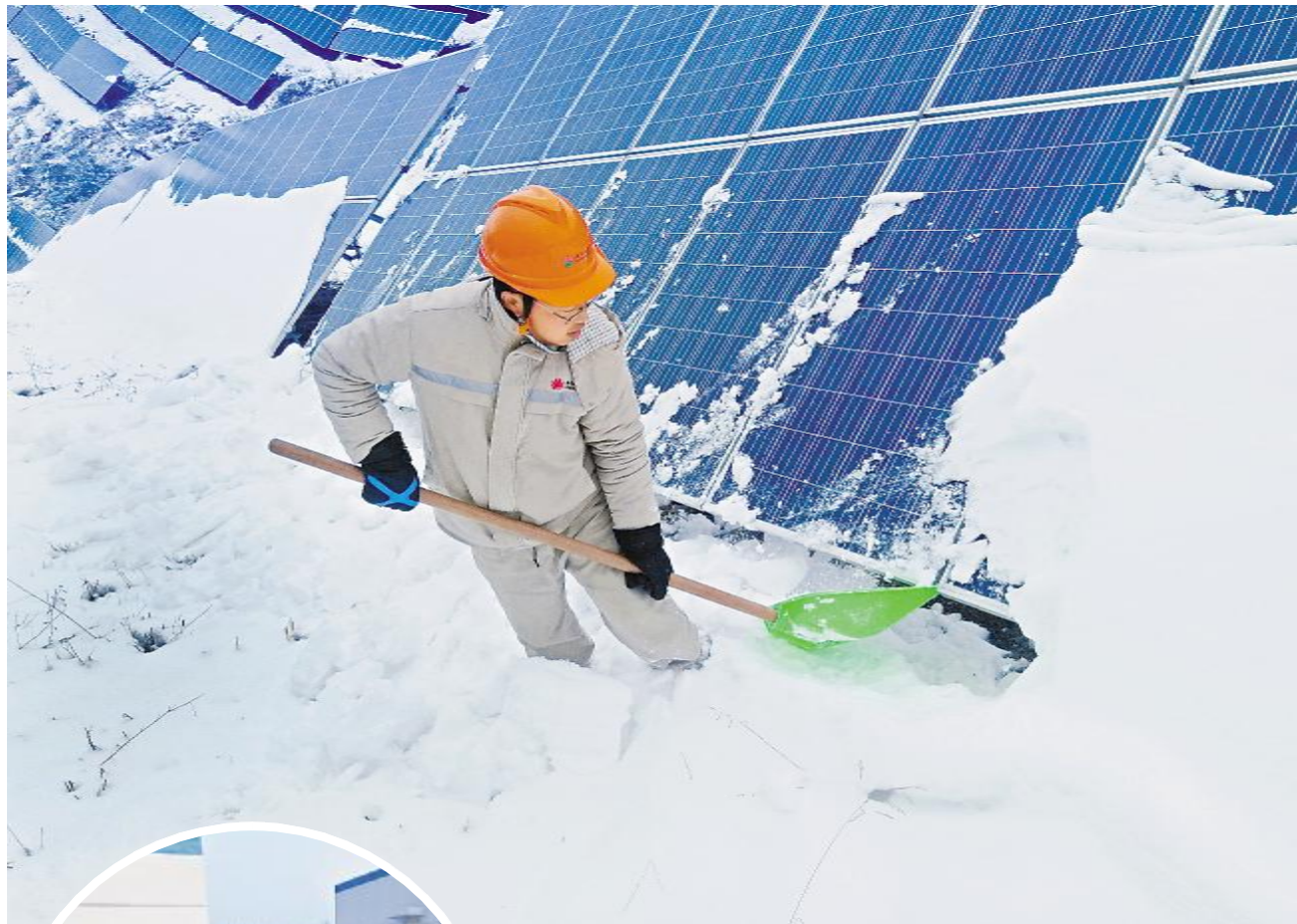
泽州电站运维人员清除光伏板积雪
