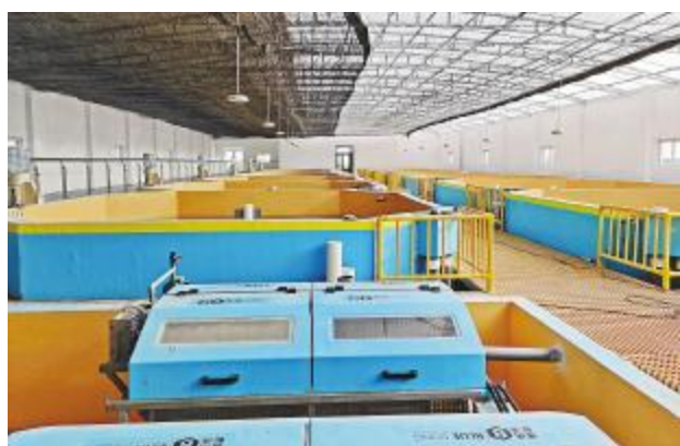
新建成的东营项目工厂化循环水养殖车间
